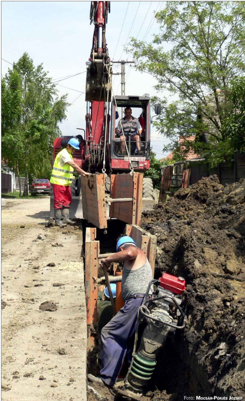
Ajtósfalván is jól haladnak a kivitelezők. A Hódi utcában, a több mint 600 méter hosszú szakaszból, 400 méteren fektették le a gerincvezetékét (felvételünk is itt készült). A Pósteleki utcában a házi bekötéseket befejezték, a Fűrj utcában pedig elkezdték a 690 méter hosszú gerincvezeték kiépítését
